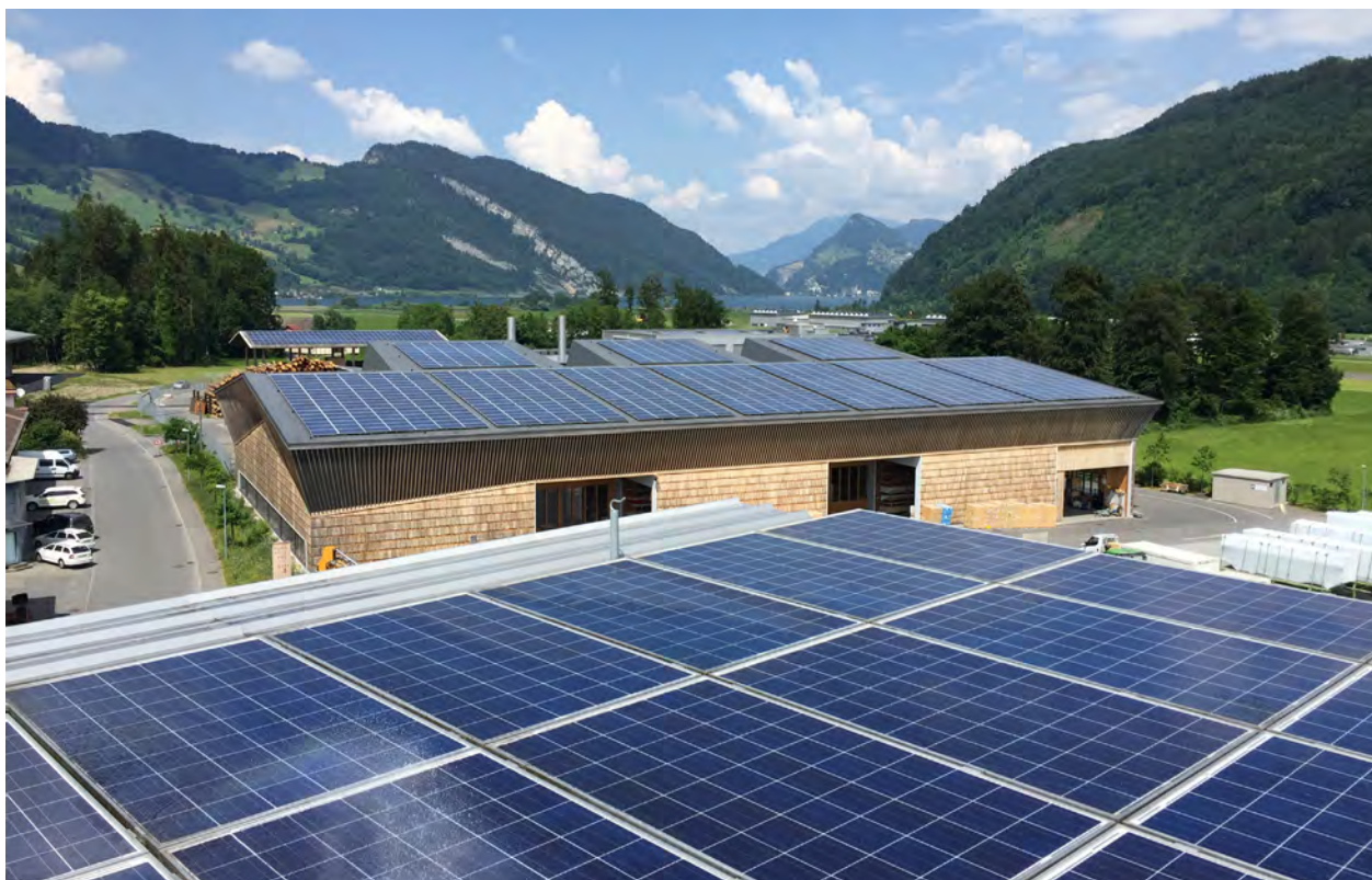
Symbolbild: Photovoltaikanlage auf unserem Büro- und Gewerbegebäude Chilcherlistrasse 1
